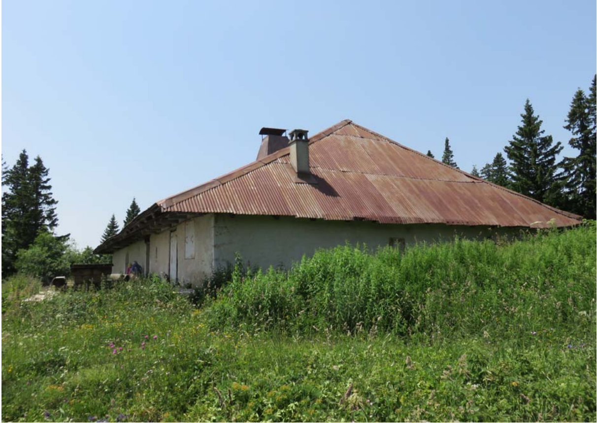
Pignon nord-est. Mais où sont donc passée les chéneaux qui permettraient de récolter l'eau du vaste toit afin de remplir quelque citerne de proximité ?
